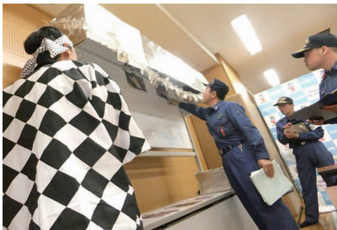
写真2 想定違反箇所（天蓋 清掃不良）
